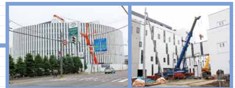
6月25日 入院治療棟(南東から撮影)は工事のための足場がすべて撤去されました。
